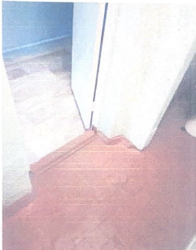
ФОТО № 4 Санитарно-гигиенические помещения: В санитарно-гигиенических помещениях нет знаков доступности, туалетные кабинки не соответствует установленным нормам.
