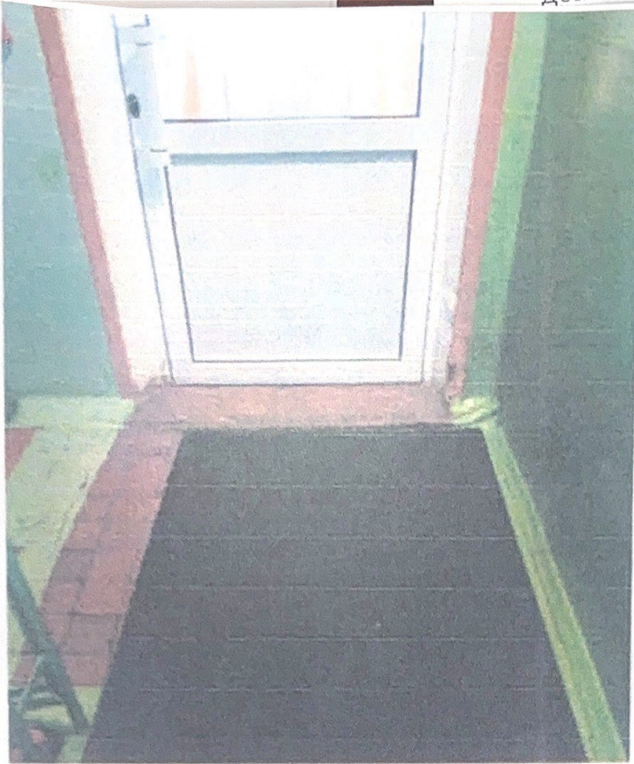
ФОТО № 5 Входная группа главного входа: Высота порогов и перепад высот более 14мм, ширина дверных проёмов менее 90см, ширина лестничной площадки = 2*0,9 метра, что не соответствует нормам.
